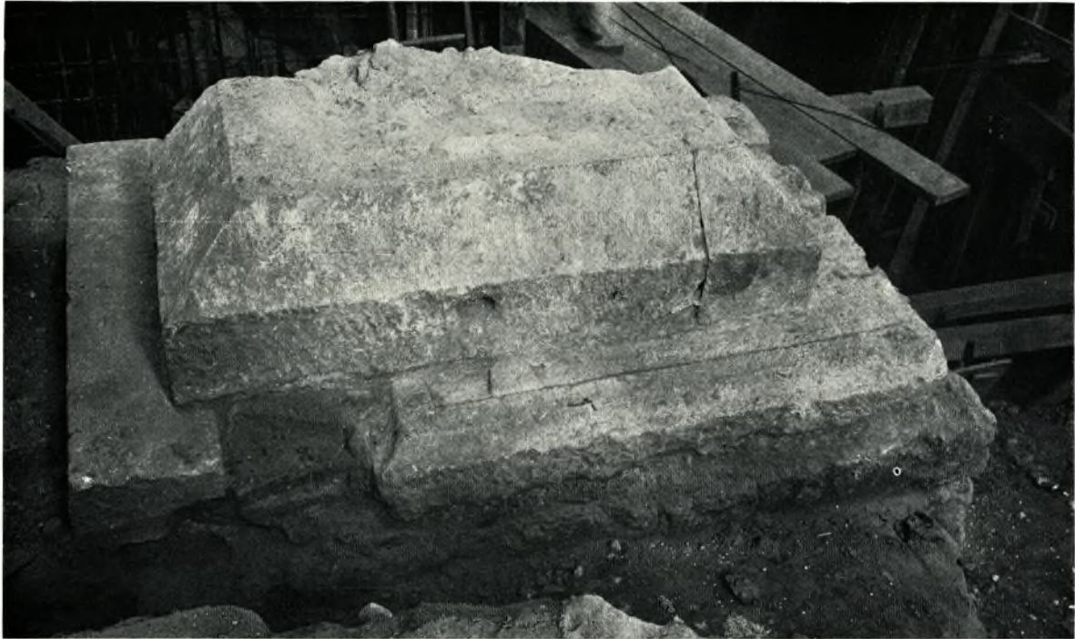
a Sockel des mittleren Pfeilers (Pf. II) von S. Der Nordteil ist bereits abgebrochen.
